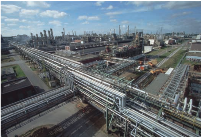
Abbildung 1-1 Rohrleitungen im Chemiepark Marl
