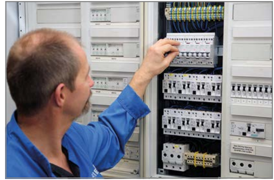
Bild 1: Verteilerschrank einer Elektroinstallation mit Schutzschaltern www.siemens.com
