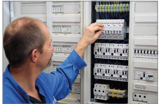
Bild 1: Verteilerschrank einer Elektroinstallation mit Schutzschaltern www.siemens.com
