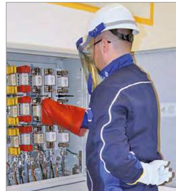
Bild 2: Elektrofachkraft beim Ziehen eines NH-Sicherungseinsatzes
