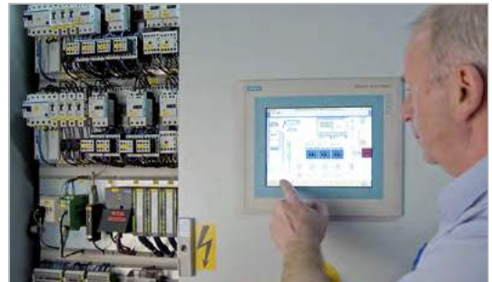
Bild 2: Umwelttechniker an einer Anlage zum Wasserrecyceln in einem Hallenbad
