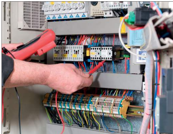
Bild 1: Spannungsmessung an einem Hilfsschutz
