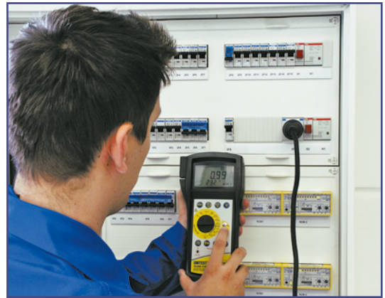
Bild 1: Messen der Fehlerschleifenimpedanz mit einem Multifunktionsmessgerät nach DIN VDE
