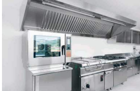
Festinstallationen in der Küche reinigen.
